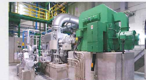
12 蒸気タービン発電機 ボイラで発生した蒸気のでタービンを高速回転させ発電します。
