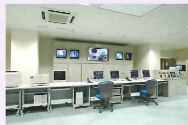
●中央操作室 溶融設備の運転制御をはじめ、施設全体の管理を行います。
