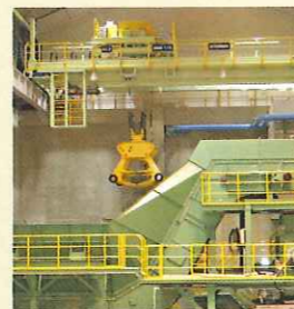
4 ごみクレーン ピット内のごみを均一にし供給コンベアへ運びます。
