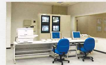
中央操作室 リサイクルプラザ内の各機器の操作や監視をします。
