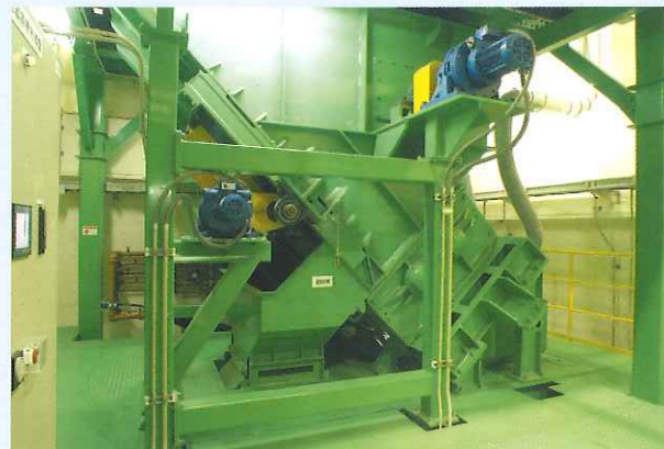
① 粗破砕機 ゆっくりと回転する引き裂き刃で大きなごみを大まかに切り裂き、その後の処理を安全かつスムーズにします。
