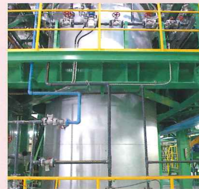
8 減温塔 溶融炉で発生したガスに霧状の水をかけて、1秒間で1000℃から200℃以下まで一気に冷やして、ダイオキシン類の再合成を防ぎます。
