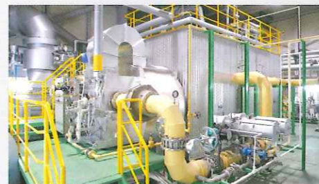
11 ボイラ 溶融炉から発生したガスをボイラで完全燃焼し、発生した熱を回収して蒸気を発生させます。
