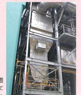
10 脱硫塔 薬品と反応させてガス中の硫黄分を取り除きます。
