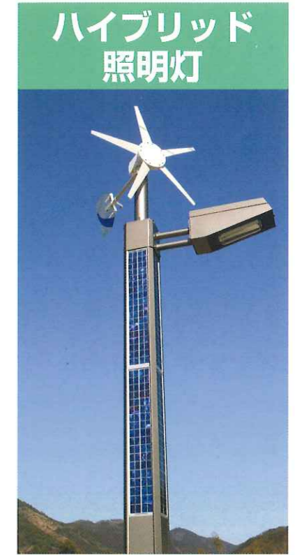
街路灯は、風力と太陽光の組合せによって発電します。
